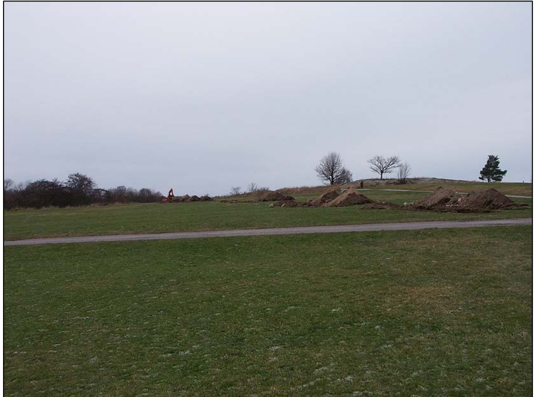
Fig. 5. Schaktning för den nya GC-vägen. Dag 1. I bakgrunden syns klippan med ristningarna. Fr SÖ. Foto: Per Nilsson.
