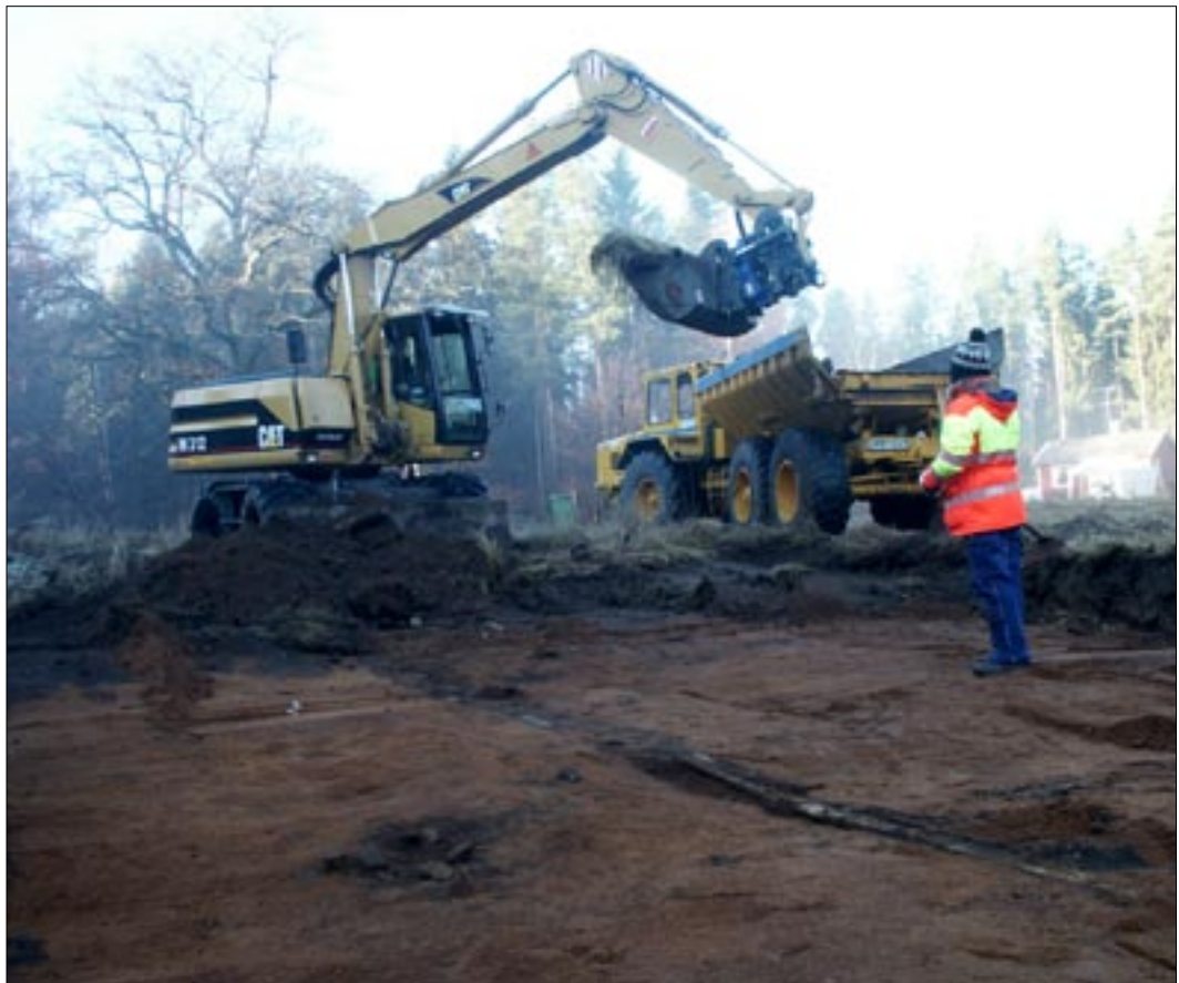
Fig 4. Schaktning med grävmaskin inom Område 1 under senhösten 2003. Lämningarna framträdde tydligt i den sandiga undergrunden. I förgrunden syns den delvis översandade mesolitiska härden A1200 bredvid en sentida telekabel. Foto från SÖ.
