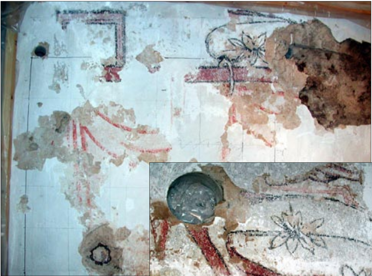
Fig 26. Landeryds kyrka. Norra transeptet, västra muren interiört, rester av kalkmålningar framtagna och dokumenterade, på platsen för murgenombrottet.
