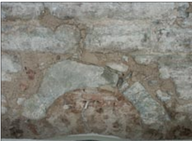
Fig 20. Landeryds kyrka. Tornet, västra fasaden, äldre rundbågig öppning ovan västportalen. Foto från väster, RAÄ UV Öst.
