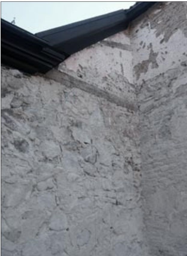
Fig 30. Landeryds kyrka. Norra transeptet, höjning av västmuren, samt långhusmuren, i samband med kyrkans ombyggnation 1753. Foto RAÄ UV Öst .
