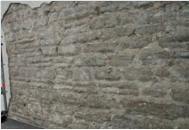
Fig 18. Landeryds kyrka. Tornet, södra fasaden, murverk fas 2. Foto från söder, RAÄ UV Öst.
