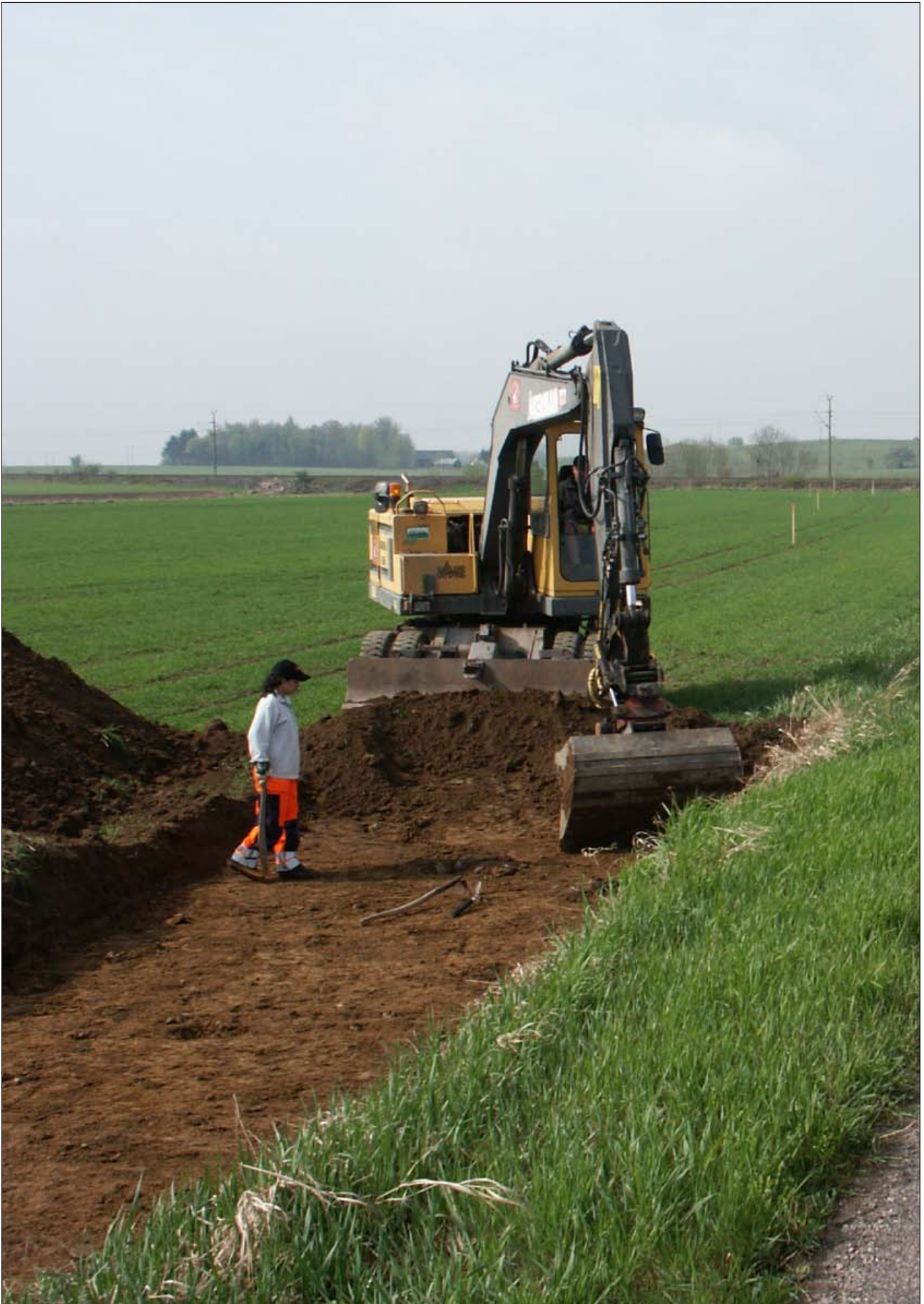
Fig 10. Översiktsfoto över undersökningsområdet vid Landstorp under den första schaktdagen. Vyn är riktad mot väster och i horisonten ser man Högrabacksgravfältet. Foto RAÄ, UV Öst.
