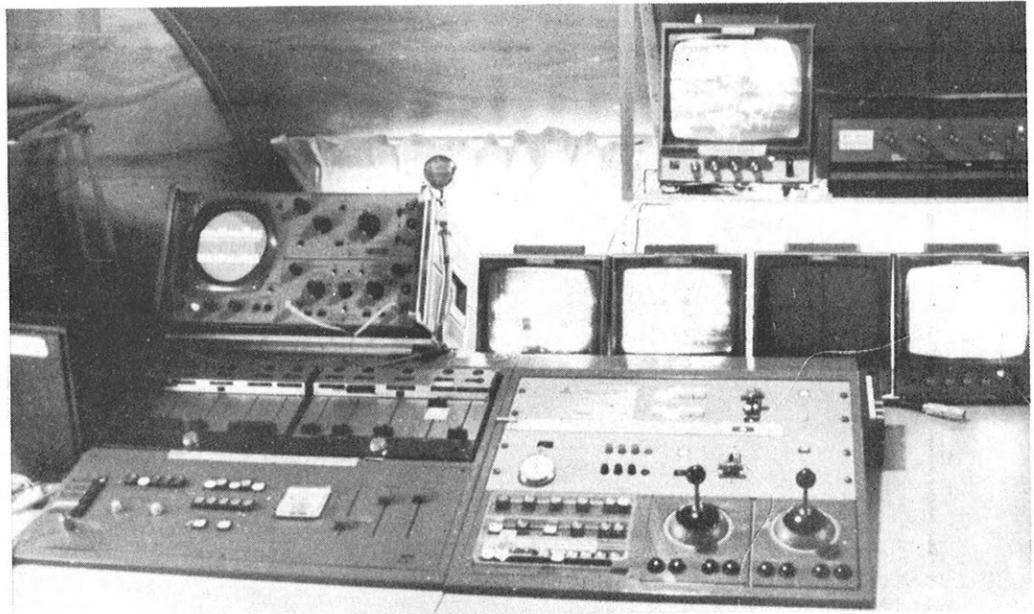
Fig 25. Interiör från husvagnen. Kontrollbord
